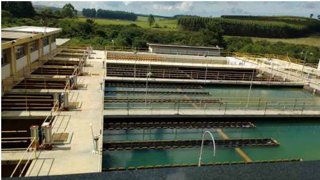
FIGURA 8.6 ESTAÇÃO DE TRATAMENTO DE ÁGUA V DO DMAE
